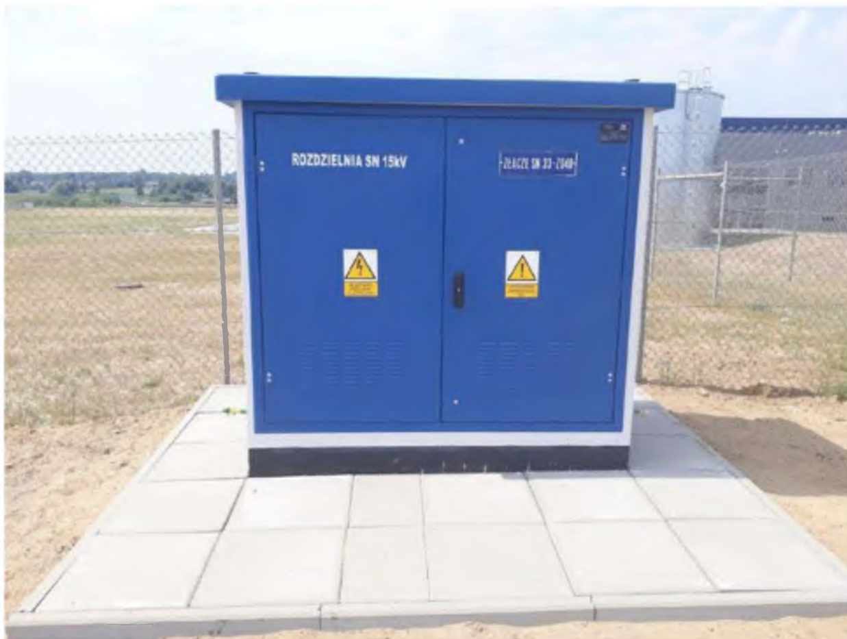
Fot. – rozdzielnia SN 15kV– ul. Górka Kłocka – dostępna moc 2000 kW (2MW)
