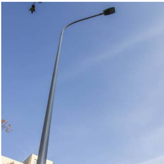
Modernizacja oświetlenia ulicznego na terenie Sieradza – 212.988,10 zł
